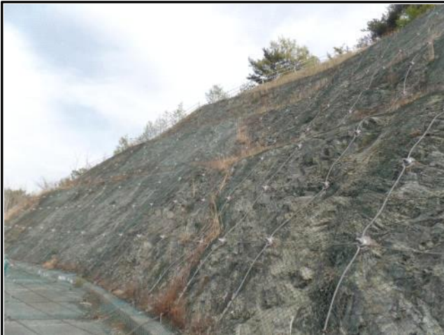
⑦ 4+920 지점 : 3소단 상부 심한풍화 및 락볼트 상태양호
