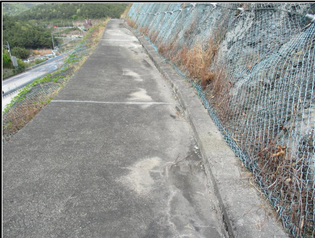
⑬ 4+940 지점 : 1소단 배수로 체수혼적
